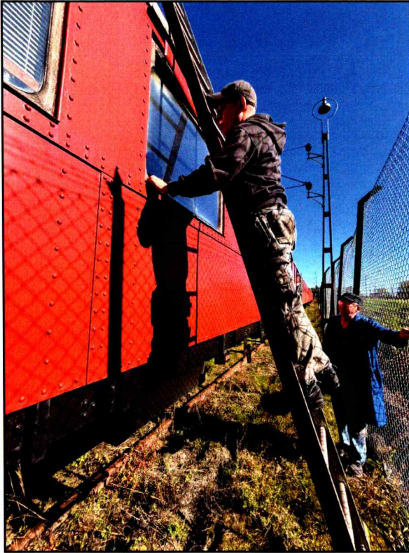
Martin kollar ett läckande fönster på RCo1. Foto Benjamin A-L.
