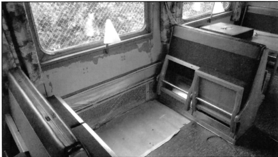
En vägg i RCo1 som måste bättringsmålās. Foto Martin N
