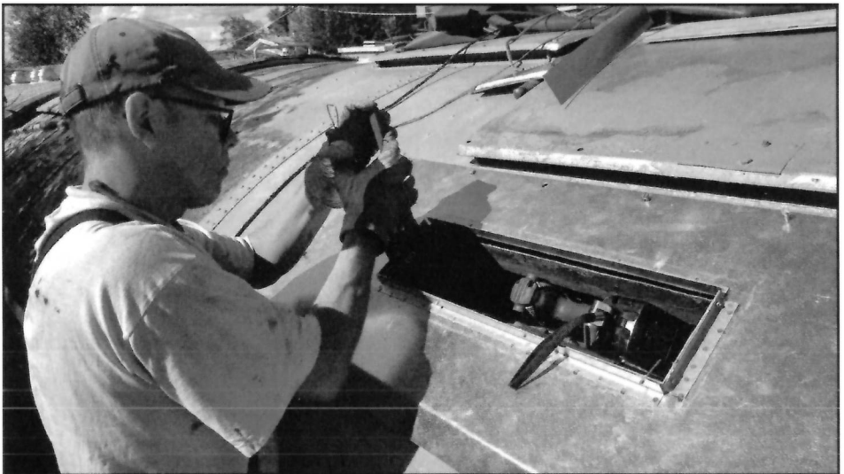
Martin arbetar med montering av en ventilationshuv på RCo1. Foto Dan C.
