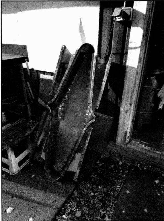
Ventilatorhuvnen till RCo1.
