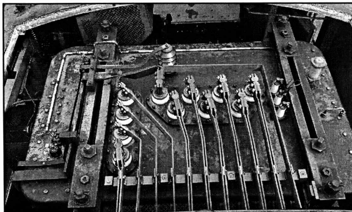
Så här ser ovansidan av huvudtransformatorn på Du2 349 ut efter rengöring.
